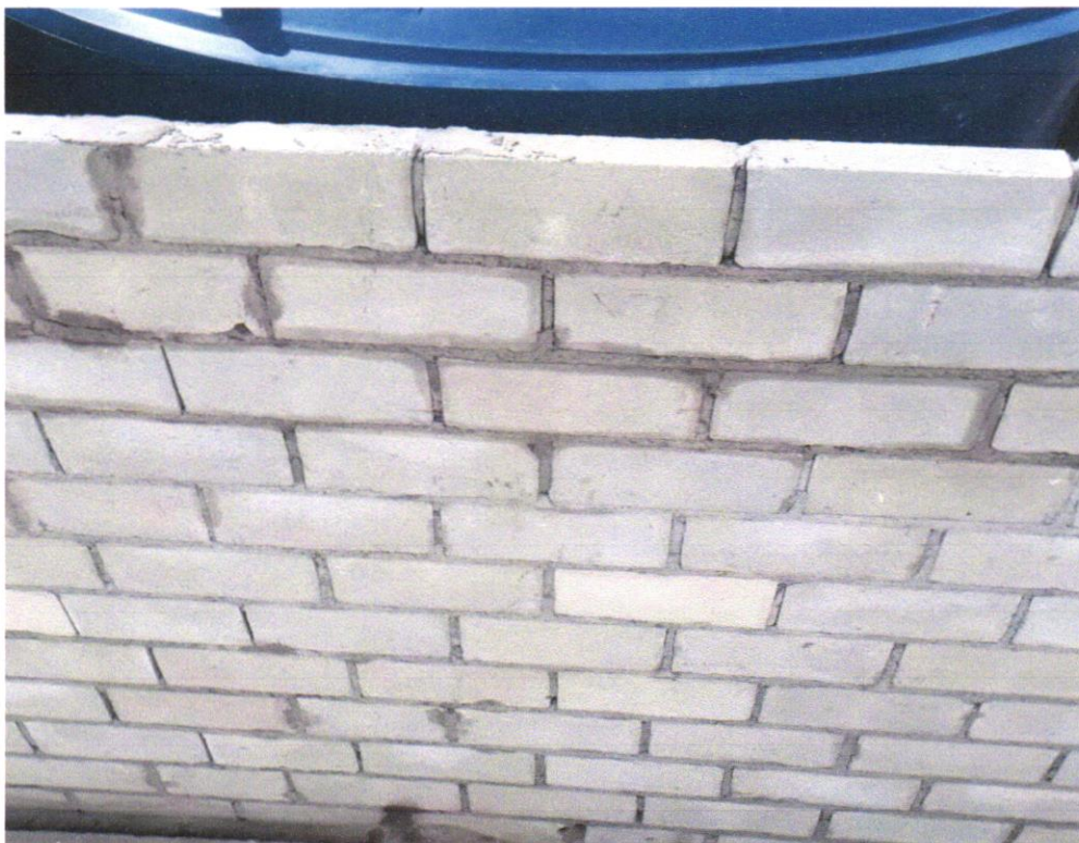
Foto 06 - ALVENARIA DE BLOCOS DE CONCRETO ESTRUTURAL 14X19X29 CM, (ESPESSURA 14 CM) FBK = 14,0 MPA, PARA PAREDES COM ÁREA LÍQUIDA MAIOR OU IGUAL A 6M 2 , SEM VAOS, UTILIZANDO PALHETA. AF_12/2014
